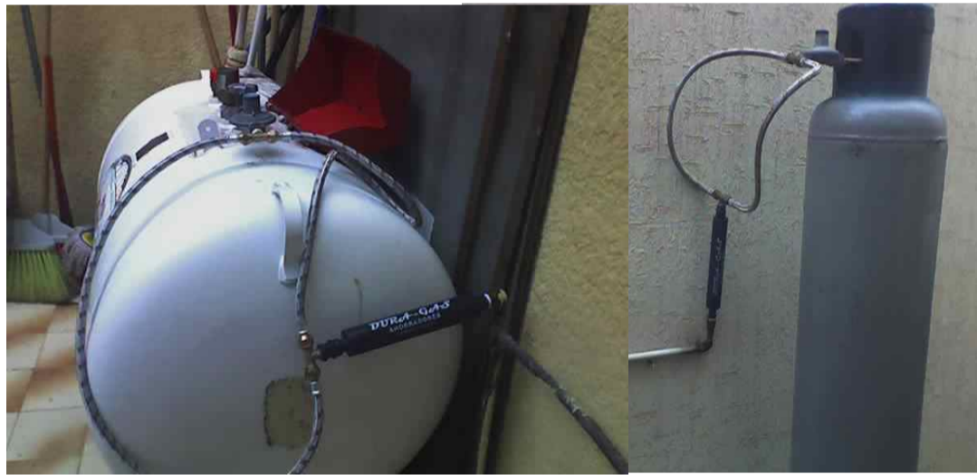
Fig 2. Dispositivo instalado en regulador y tubería de gas.
