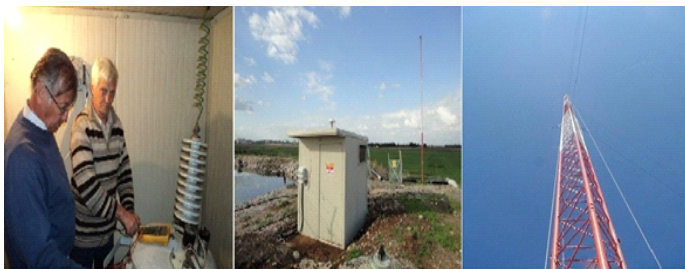
Figura 2. Estación de Ionización Atmosférica instalada en Kibbutz Ein Hamifratz.
