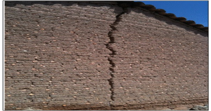
Figura 3. Agrietamiento en vivienda guerrerense de adobe
